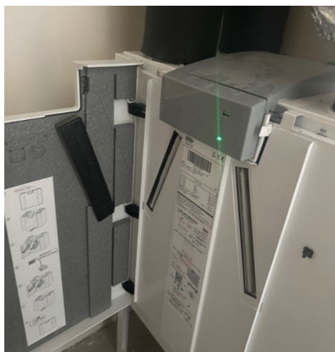
Filters ventilatie unit
